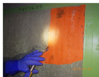
剥離時の状況
