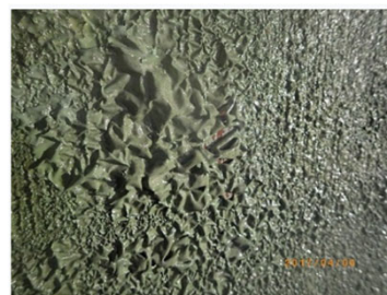
リペアソルブSが塗膜に十分浸透し、浮き上がった状態
