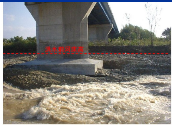
橋脚部の深掘れ状況 (平成16年10月洪水 満濃大橋)
