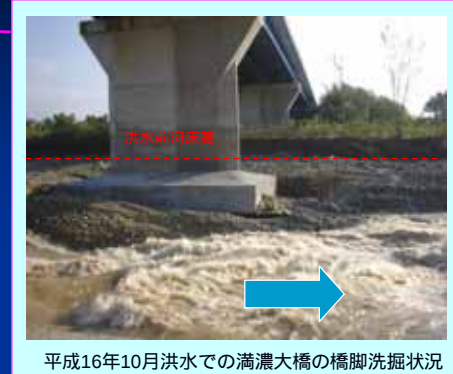
平成16年10月洪水での満濃大橋の橋脚洗掘状況
