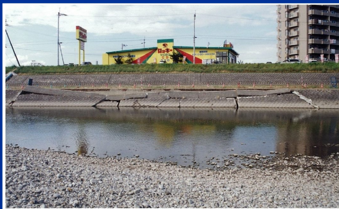
河岸侵食、護岸崩壊状況 (平成13年8月洪水 河口から2.0km)
