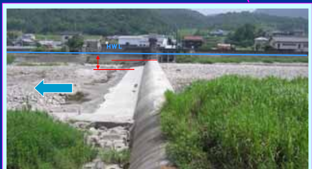
大川頭首工の河積阻害状況
