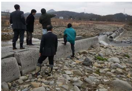
現地調査(百々井頭首工 施設被害)
