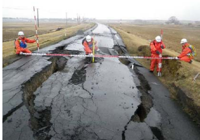
被害状況の調査(堤防のクラック)
