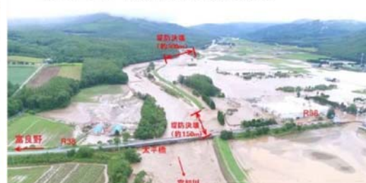
空知川(幾寅築堤)の堤防決壊 31日 4:40 空知川の堤防決壊を確認 (2カ所 延長 下流約150m 上流約300m)
