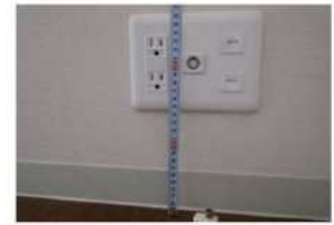
床から20cmに差込口がある コンセントとモジュラージャック
