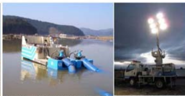
排水ポンプ車(排水能力毎分45m 3 無線操縦自走式)による作業
