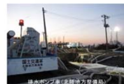
排水ポンプ車(北陸地方整備局)
