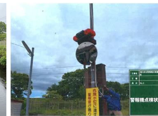
竜川水位警報機点検
