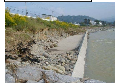
河岸侵食(まんのう町)
