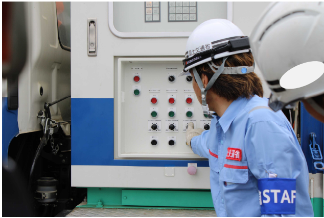
排水ポンプ起動
