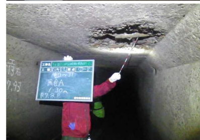
管内の腐食・破損状況
