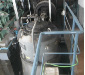
老朽化したポンプ設備
