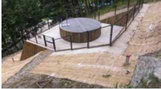
地すべり防止施設の例 (間伐材を利用した集水井)
