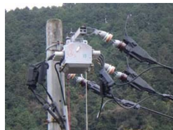
受変電設備改良
