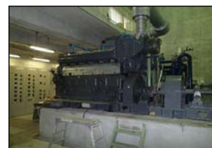
主原動機 現況
