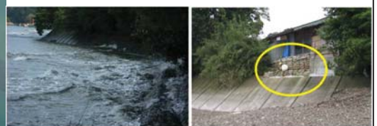
平成17年9月被災状況
