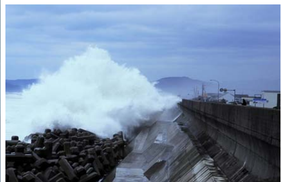
仁ノ工区の越波の状況 (平成16年8月台風16号)
