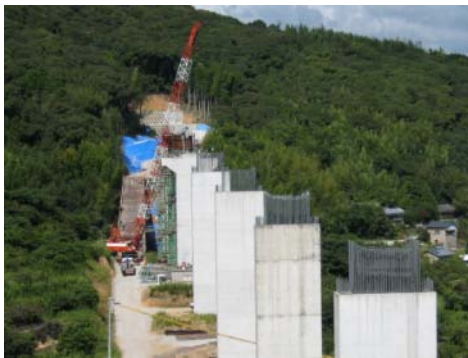
工事の進む高知東部自動車道（高知南国道路） （南国市稲生付近）
