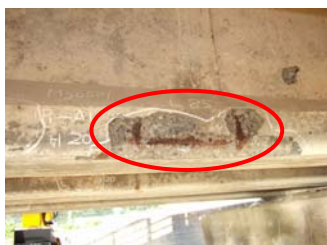
主桁の塩害による コンクリート剥離
