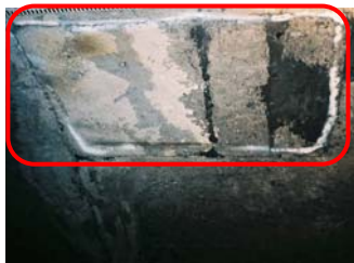
アーチ部の コンクリートの浮き
