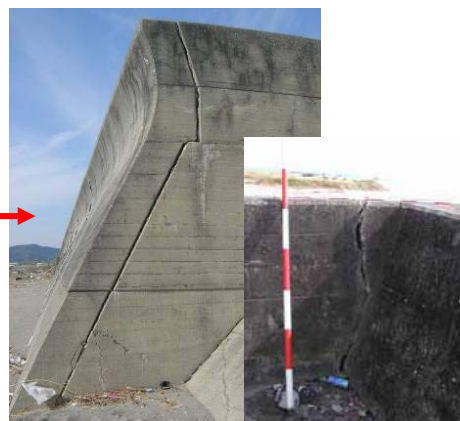
打継目が拡大し対策が必要な堤防
