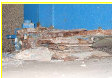
漏水による支承・下フランジの腐食(事例)
