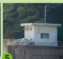
5 水力発電設備
