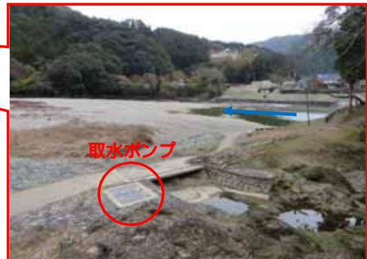
取水ポンプ設置箇所（R4.12.7撮影）
