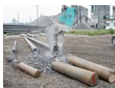
コンクリート電柱破碎
