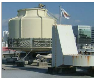
冷却塔(開放式)
