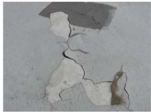
防水層の破損の事例
