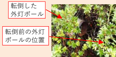
転倒した外灯ポールの根元
