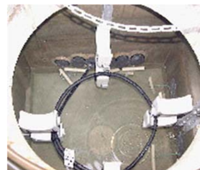
地中管路用ハンドホール (内部に水がたまっている様子)
