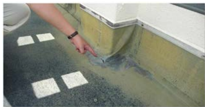
防水シートの破れ
