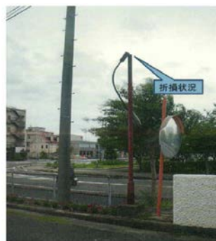
折損した外灯
