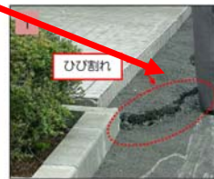
舗装面のひび割れ
