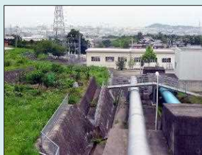
②銅山川第一発電所 水を送る際の落差を利用して発電を実施
