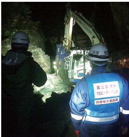
平成 29 年 11 月 愛媛県西条市県道 12 号崩落 遠隔操縦バックホウによる崩壊 岩石の撤去活動
