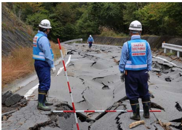
R1. 10. 16 道路班 被災状況調査 (群馬県多野郡上野村)
