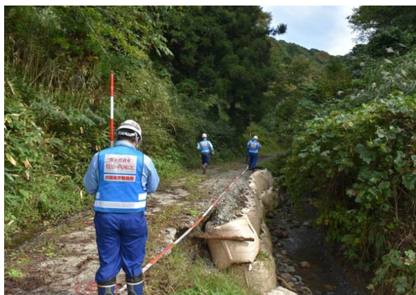
R1.10.17 道路班 被災状況調査 (新潟県妙高市)
