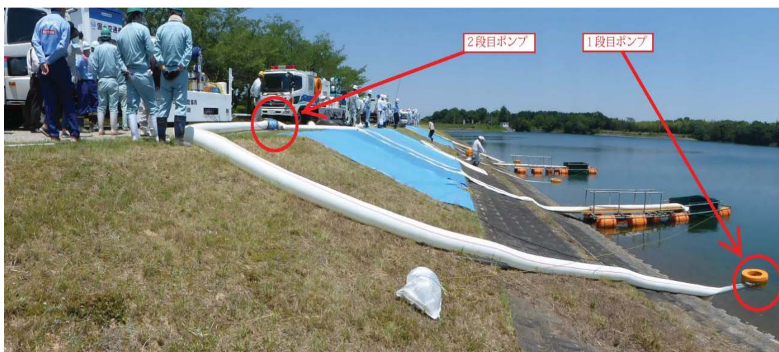
排水ポンプ車（高揚程型）の設営状況
