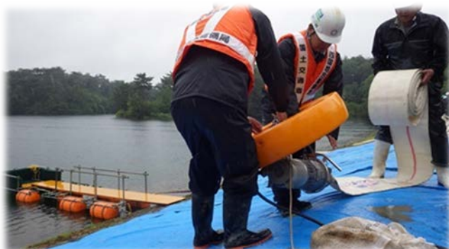
ポンプにフロートを取付
