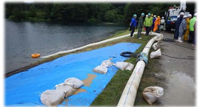
排水運転状況
