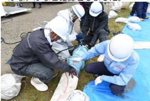
高揚程ポンプ接続
