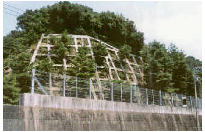
写真 - 4 55号海部5(C)工区 施工後3年半後の状況
