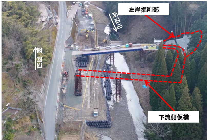
工事区間の全景(H30.1.15) 左岸掘削及び法面吹付が完了し、下流側仮橋の下部工に着手しました。 (主)小田河辺大洲線上空より望む
