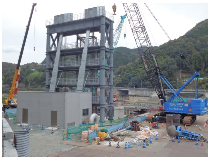
呑口部 放流設備設置状況(平成30年10月)
