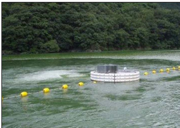
貯水池水質改善施設 (H25年度完成)
