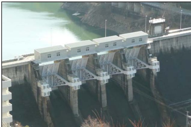
クレストゲートの改良 (H22年度完成)
