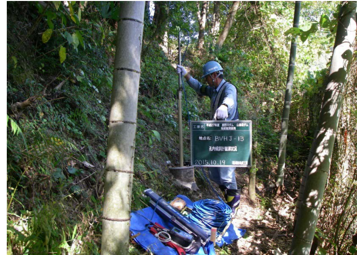
地質観測(孔内傾斜計等)
