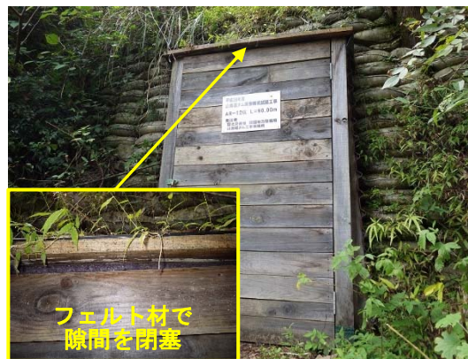
木板の反りによる隙間の閉塞 AR-12(ダムサイト右岸)
