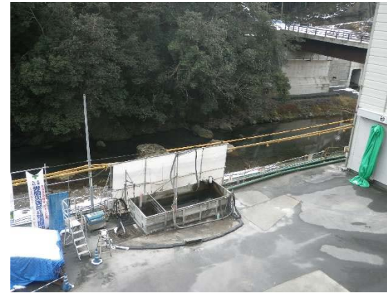
場内散水設備
