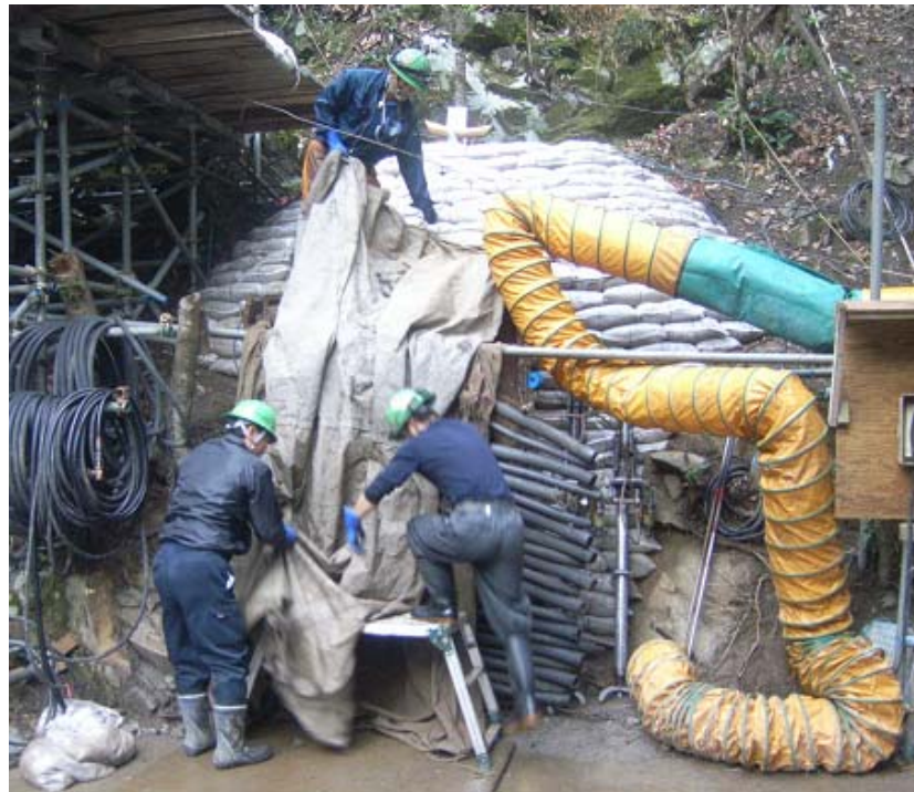
防爆シート設置状況
