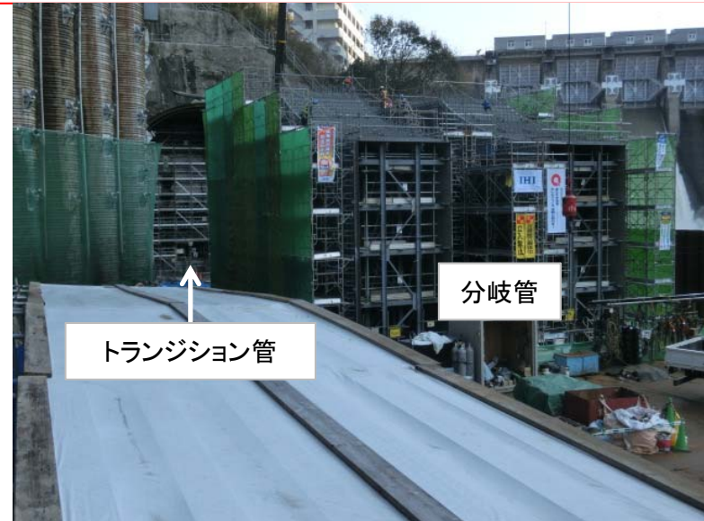
12月14日 トランジション管内部支保工撤去・分岐管鉄筋設置
