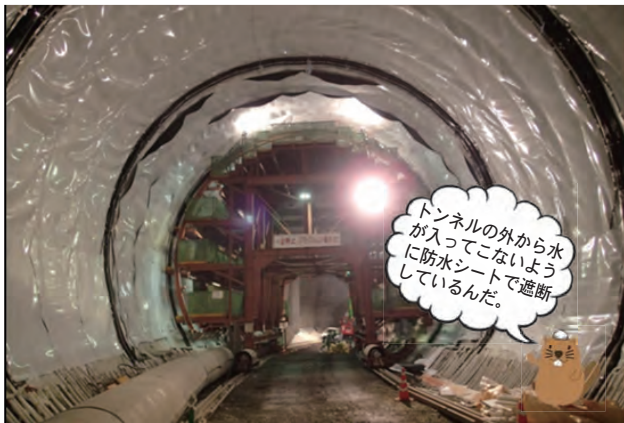
⑦掘削が終わったところから防水シートを設置します (H26.1)
