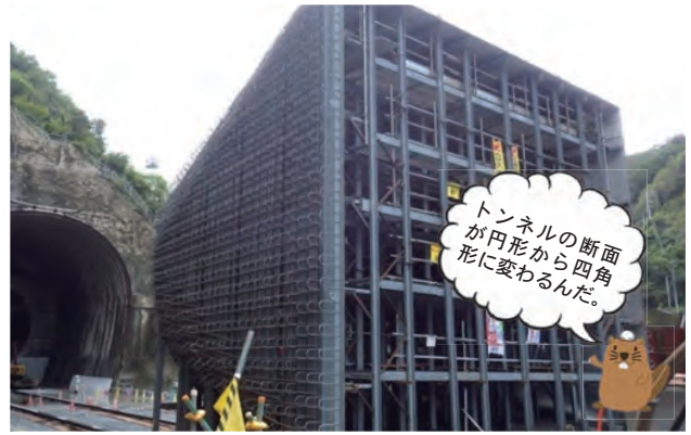
⑭水圧鉄管の下流にトランジション管を設置します (H27.10)
