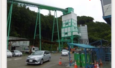
バッチャープラント コンクリートを混ぜ合わせる設備
