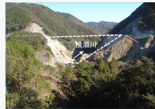
ダムができる場所の山を削っています。 (高さ72mのうち約35m切り下がっています)
