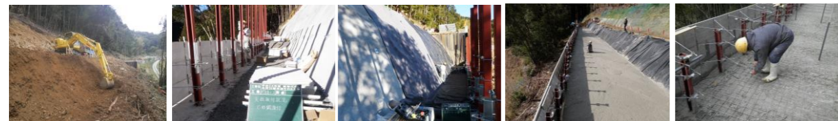
掘削 壁面材設置 遮水シート ①気泡コンクリート打設 ②補強金網設置
