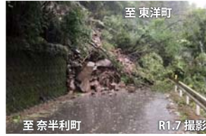
② 法面崩壊状況 (国道493号 北川村四郎ヶ野峠)
