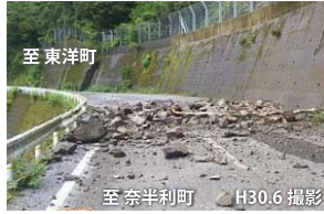
① 落石状況 (国道493号 北川村安倉)
