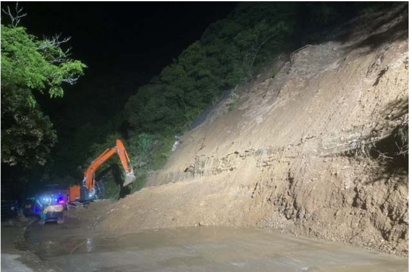
土砂撤去状況(2022. 7. 6 PM8時30分頃)
