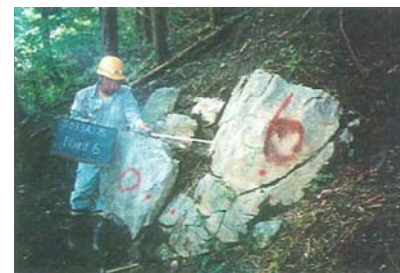
▲防災ランクⅠ 対策が必要と判断される箇所
