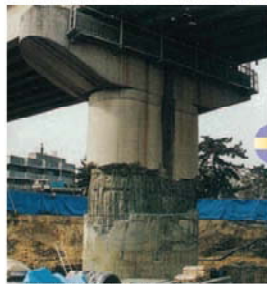
● 橋脚が損傷（阪神大震災）
