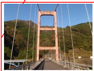
【主塔】 塗膜劣化による防食機能の低下
