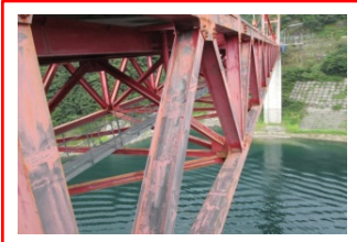
【補剛桁】 塗膜劣化による防食機能の低下
