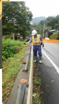
ガードレール基礎の被災状況
