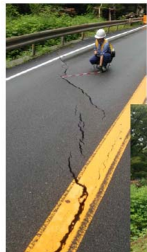
路面の被災状況
