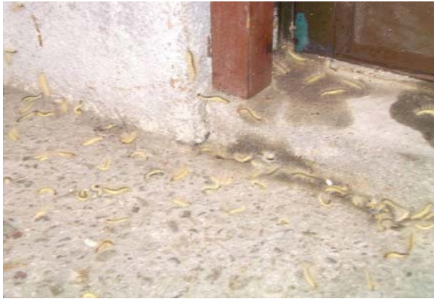
家屋への侵入状況
