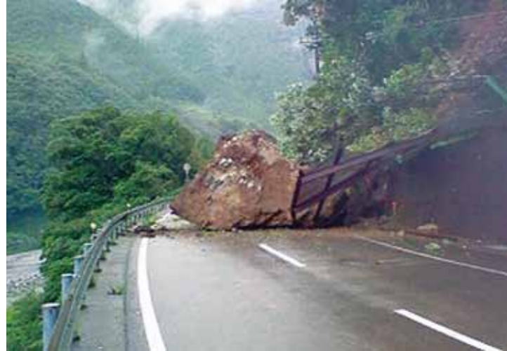
(平成22年8月16日 岩盤崩壊 越知町越知丁付近)
